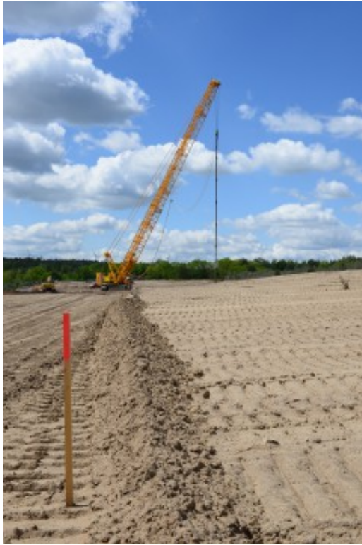
RDV-Gerät im Einsatz
